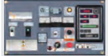
●コントロールパネル/エンジンモニタ
