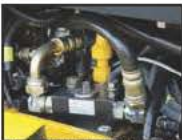
ブレーカ/共用配管切り換え弁
