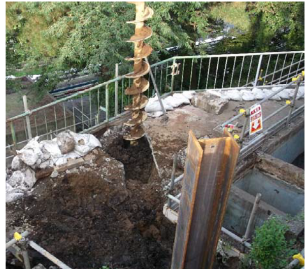
アポロンで施工困難な位置での施工 定規の設置が不要で作業スペースを確保
